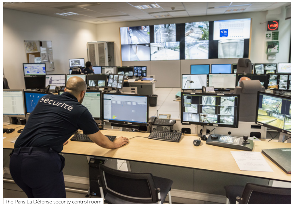
The Paris La Défense security control room
